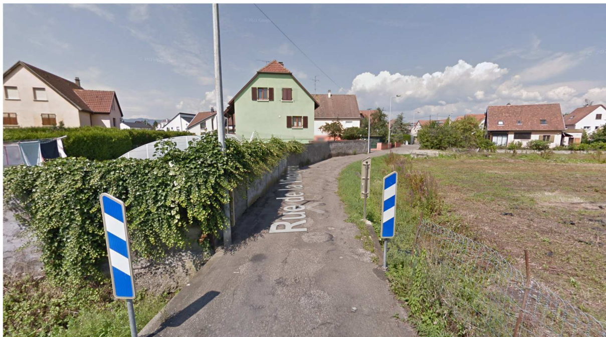
Ouvrage d'art de traversée du fossé par une voie carrossable étroite au revêtement dégradé.
